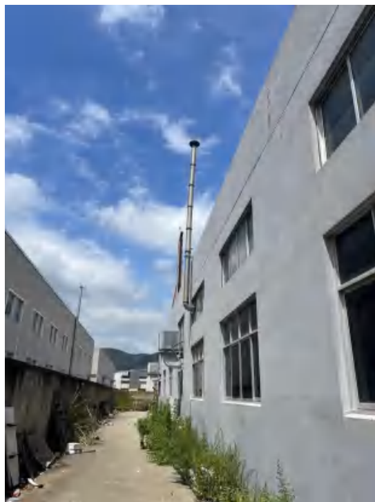
天然气燃烧废气排放口
