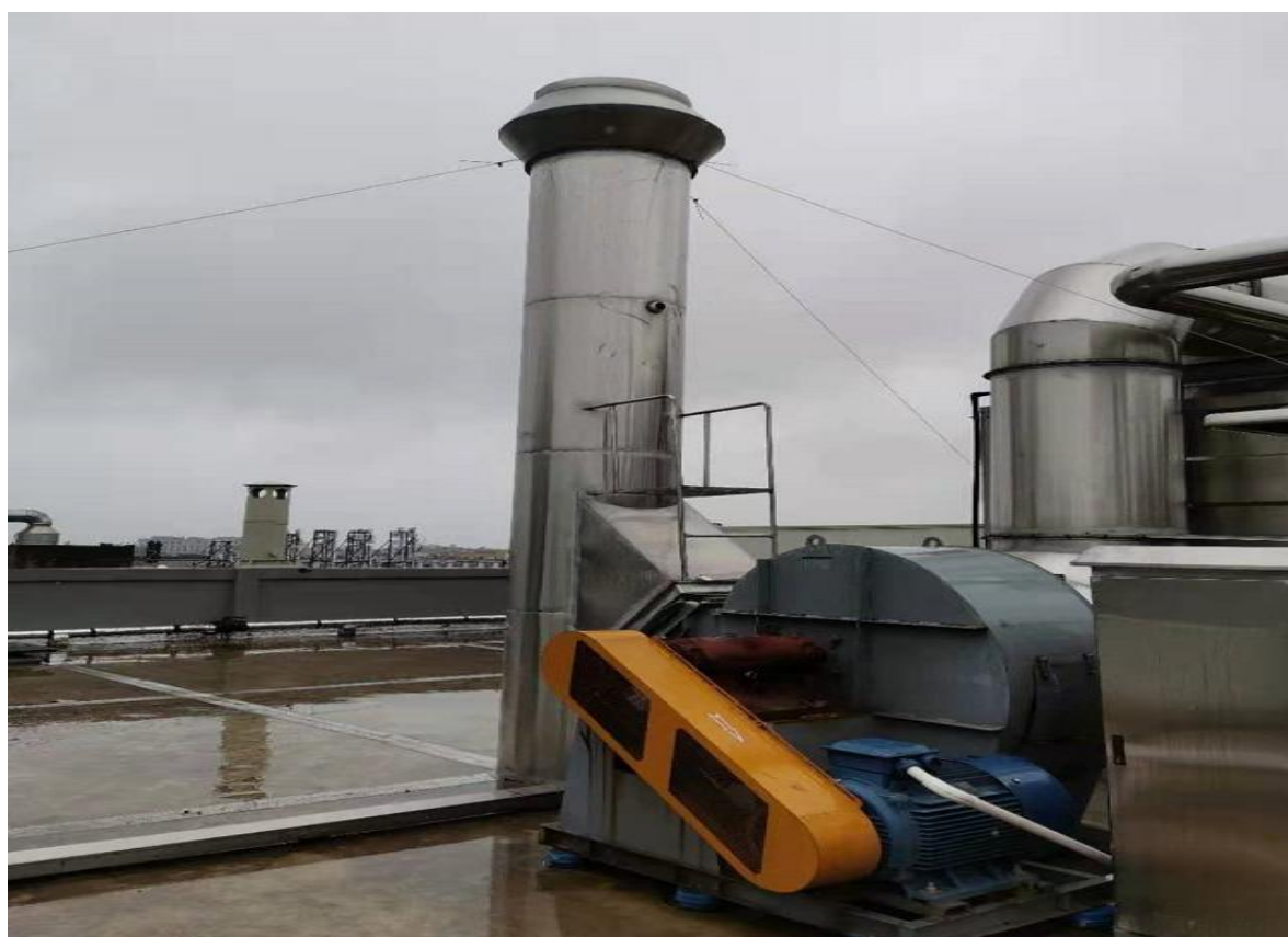
1号喷漆废气处理设施进口、出口
