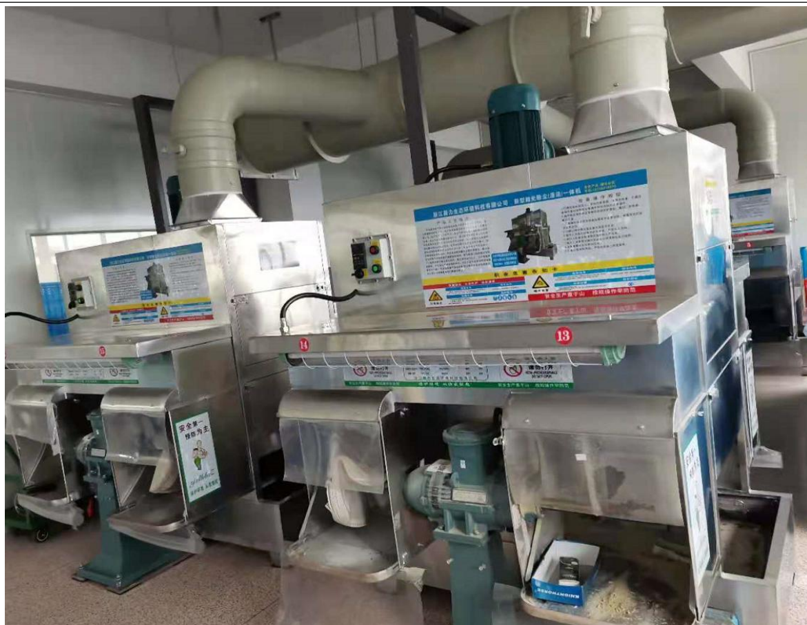
拉砂废气处理设施
