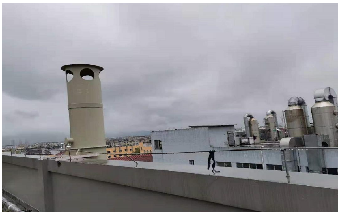
拉砂废气处理设施出口
