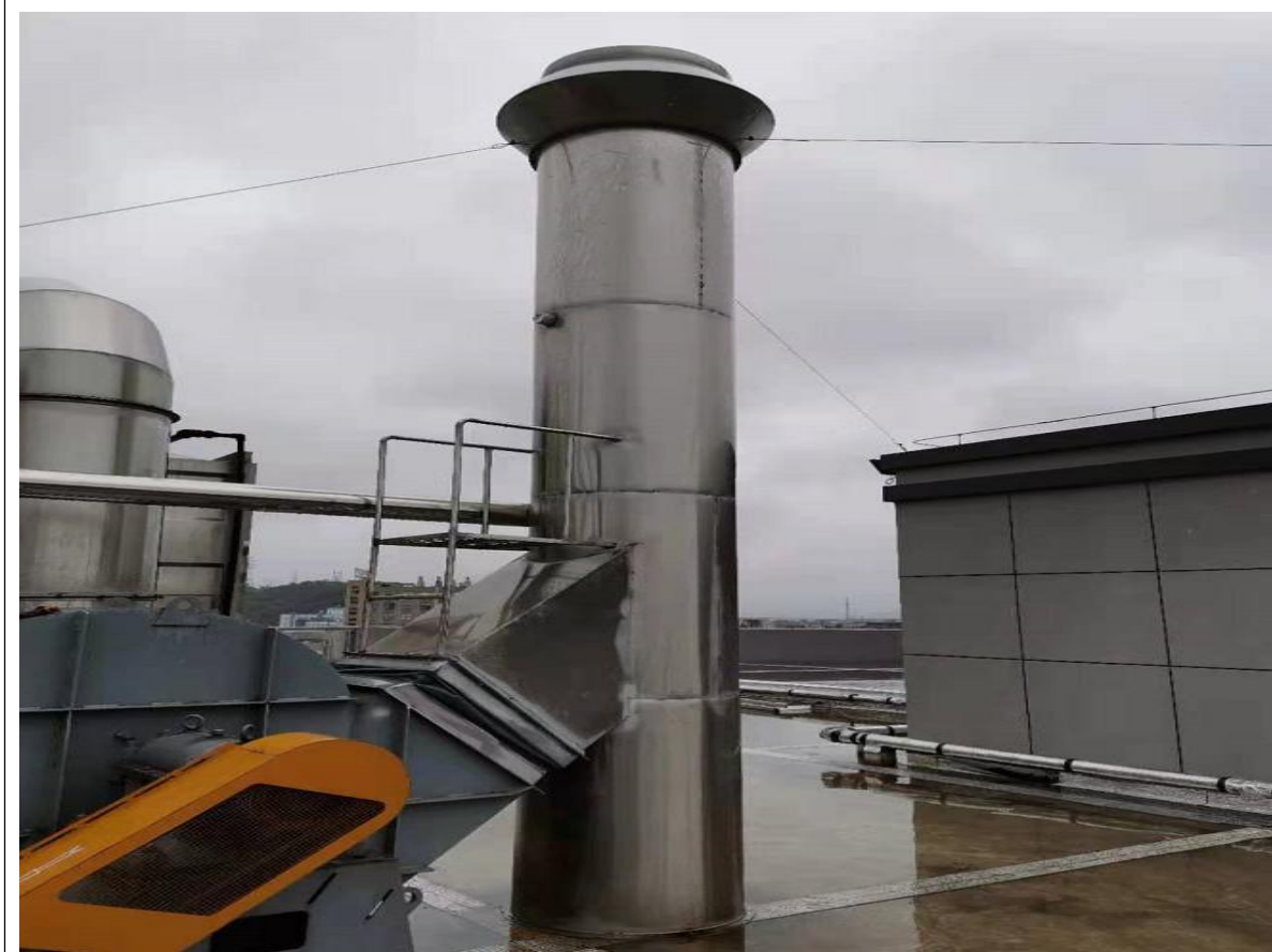
2号喷漆废气处理设施进口、出口
