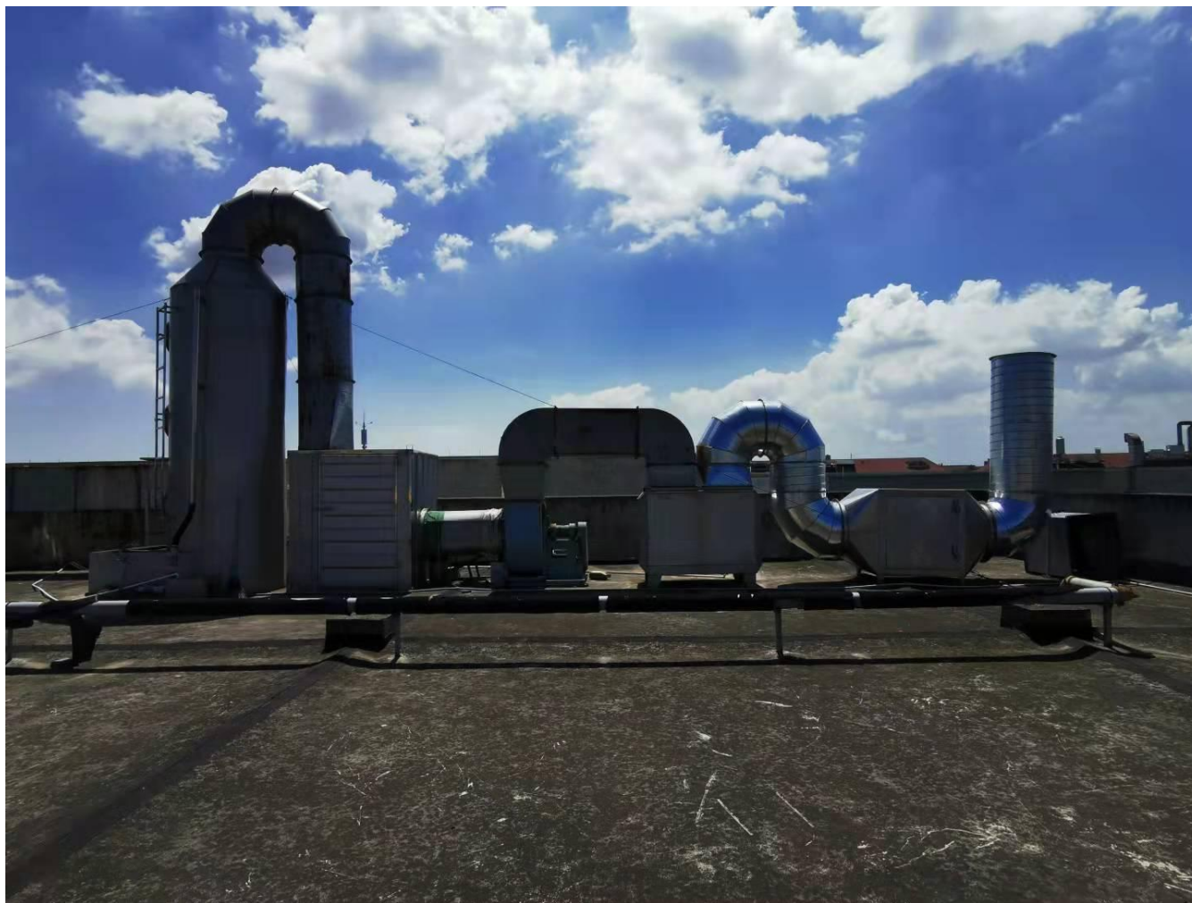
喷漆废气处理设施
