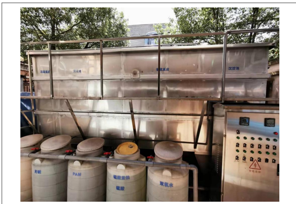
废水处理设施
